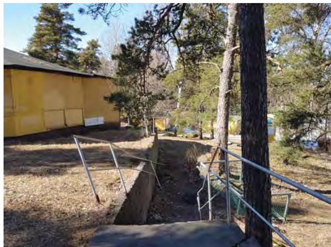
Smidesräcken är en fin kvalitet. De bör ses över, repareras och kompletteras.
