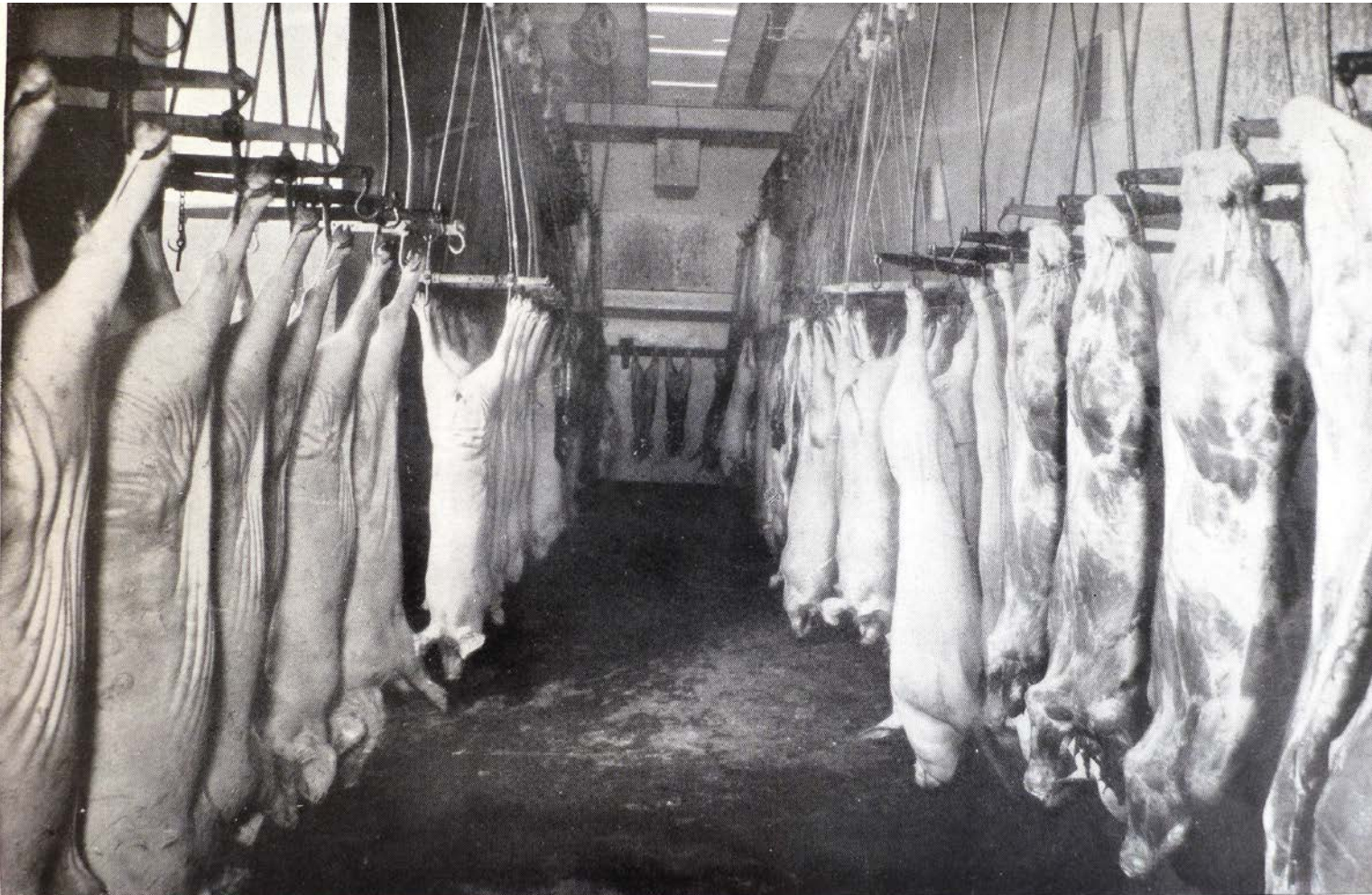
Förkyllrum i Maskin- och kylhuset. Foto fr Eskilstuna stads offentliga slakthus, Minnesskrift, 1933.
