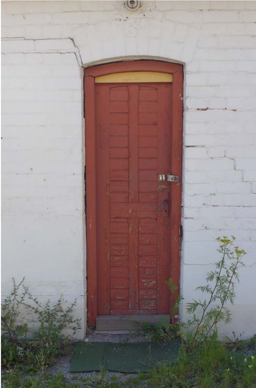
Sannolikt ursprunglig dörr till toalettavdelningen.
