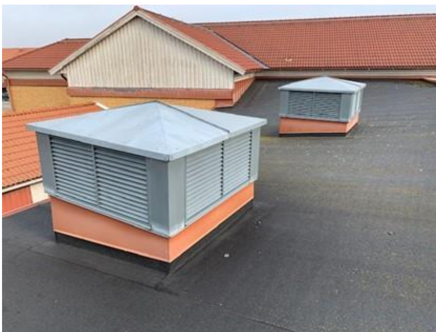
Figur 5. Willys ventilation på taket (mätposition)
