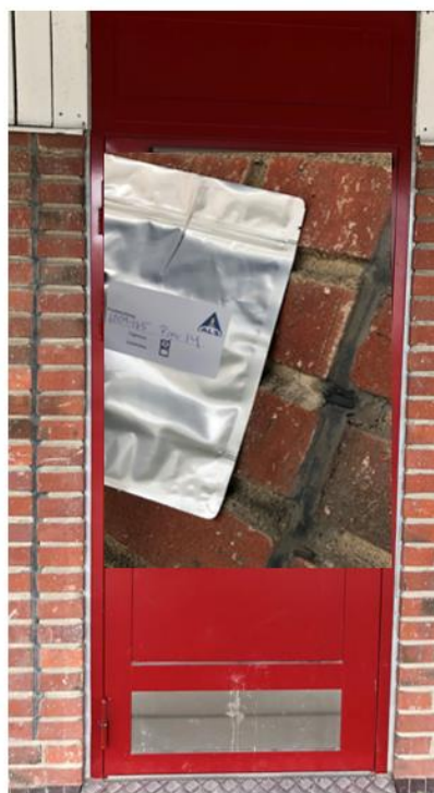
Prov 14 – fog som går vertikalt till höger om dörr till tvättstuga. Innehåller höga halter av PCB, utgör FA.
