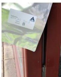
Prov 8 – fog runt glasentré till K-fast. Innehåller låga halter av PCB, utgör ej FA.
