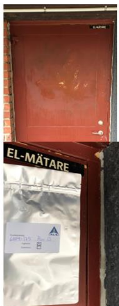
Prov 13 – fog runt dörr baksida. Innehåller låga halter av PCB, utgör ej FA.
