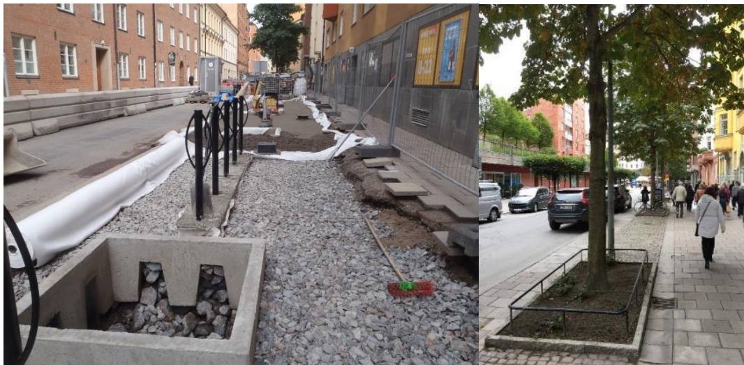
Figur 24. Till vänster: Exempel på etablering av skelettjord i befintlig miljö i Stockholm. Foto: Björn Embrén, Trafikkontoret Stockholm. Till höger: Exempel på träd i skelettjord där inloppet av dagvatten sker via brunnen till höger om trädet.
